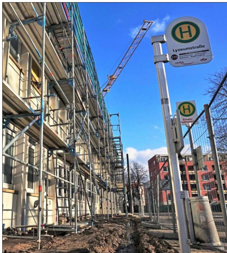
DIE ARBEITEN an der geplanten Außenstelle der Landkreisverwaltung sind in vollem Gange. Bislang sind dreiviertel der ausstehenden Arbeiten vergeben. Foto: Collet
